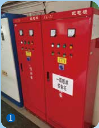
1 消防喷淋控制柜
